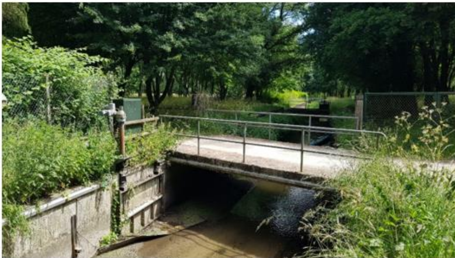
Pont amont contigu de la vanne de décharge de la Bièvre et des murs de propriétés
