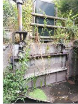
vanne de décharge amont
